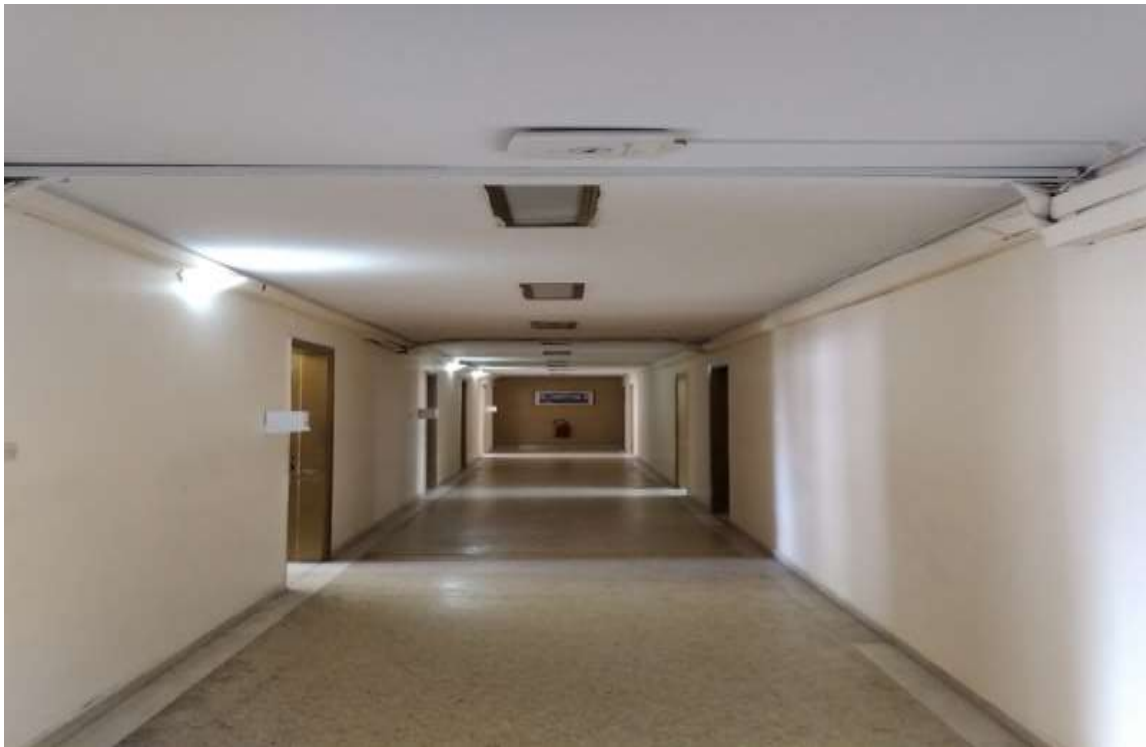
Εικόνα 5 : Δημαρχείο Αγρινίου –Φωτισμός Διαδρόμων
