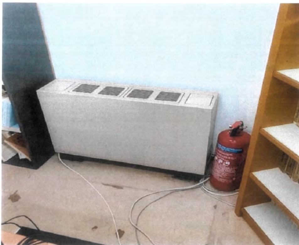
Εικόνα 6: Μονάδα Fan Coil
